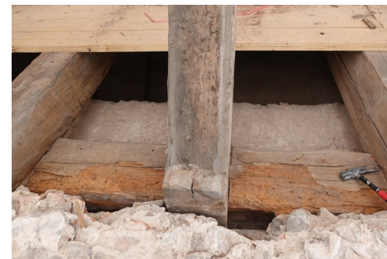
Freigelegter Deckenbalken – mit deutlich sichtbarem Schadensbild
