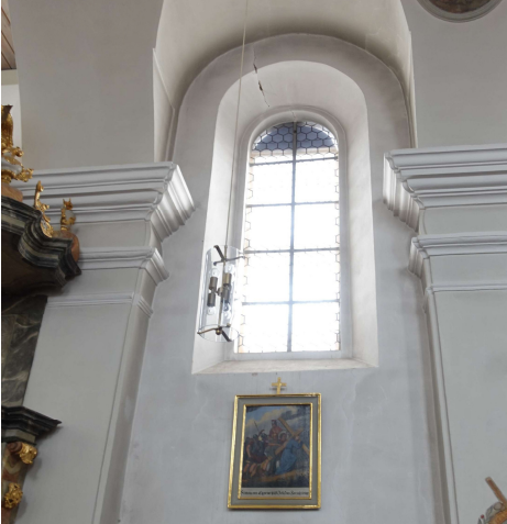
Risschaden in der oberen Fensterleibung
