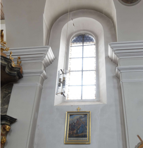
Risschaden in der oberen Fensterleibung
