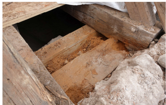
freigelegte Balkenlage des Daches – mit erkennbaren Schäden an den Balken
