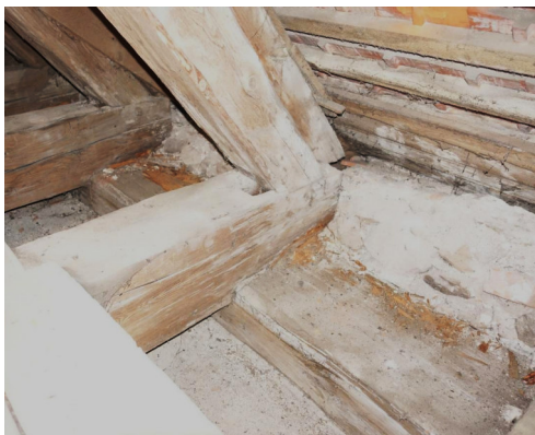
Fäulnisschäden Mauerschwelle und Zerrbalkenköpfe
