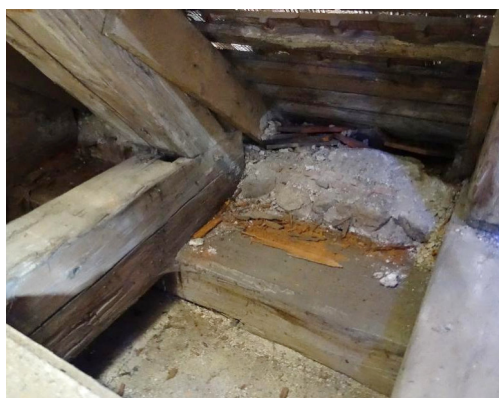
Fäulnisschäden Traufbereich Mauerschwelle und Zerrbalkenköpfe
