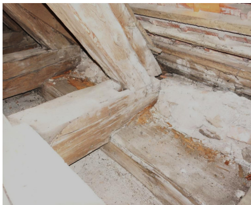
Fäulnisschäden Mauerschwelle und Zerrbalkenköpfe
