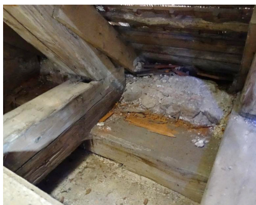
Fäulnisschäden Traufbereich Mauerschwelle und Zerrbalkenköpfe
