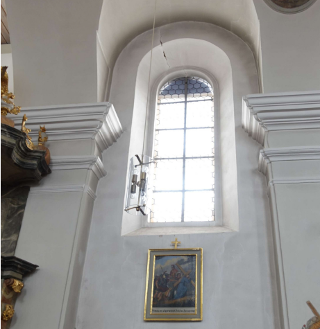
Risschaden in der oberen Fensterleibung
